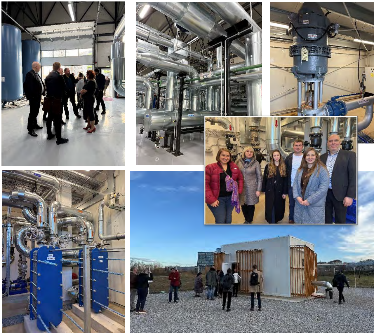
Zwiedzane obiekty generalnego systemu ciepłowniczego w Oradei
